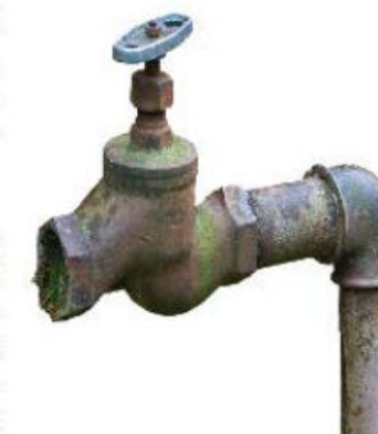
► Figura 4.19 La acumulación de depósitos sólidos dentro de las tuberías también causa corrosión.
